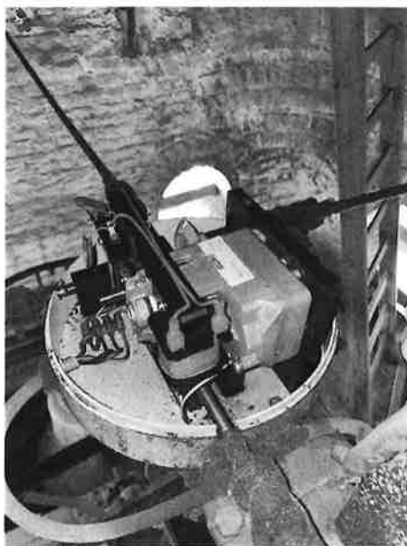
Foto 1: Het centraal motordrijfwerk vertoont algemene slijtage.
